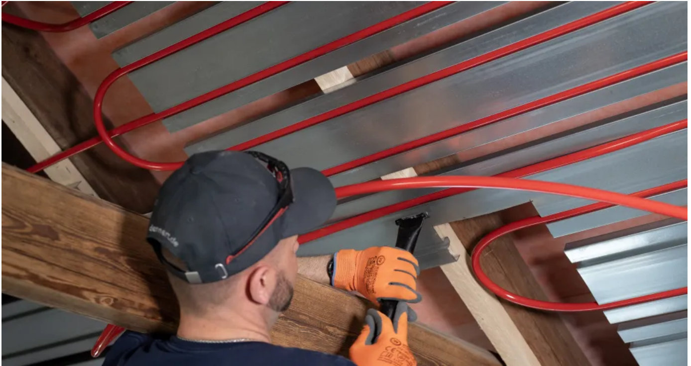
Eindrücken der Rohrleitungen - Klimaprofil TWIN zum Heizen und Kühlen (© CHR.POELLMANN)
