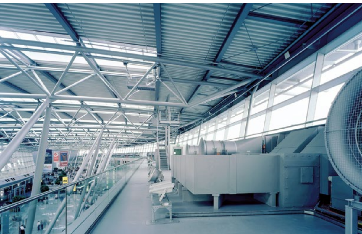
Entrauchungsanlage im Hauptgebäude am Flughafen Düsseldorf
