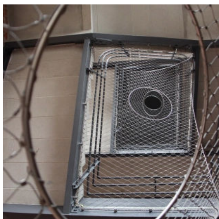
X-Tend im Treppenhaus
