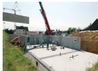
Das Dennert-Team stellt Wand für Wand auf die Bodenplatte. Jede BASE-Wand wird millimetergenau ausgerichtet.
