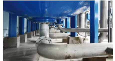
Haftungsrisiken lassen sich durch Füllwasseraufbereitung minimieren
