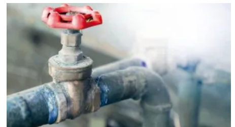
Korrosion in Rohrnetzen verursacht oft juristische Auseinandersetzungen
