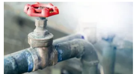
Korrosion in Rohrnetzen verursacht oft juristische Auseinandersetzungen
