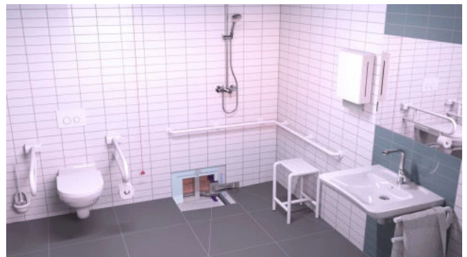
Wandablauf Scada im barrierefreien Bad
