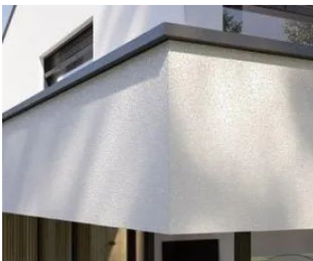
Fassadentechnik mit Spiegelbruch
