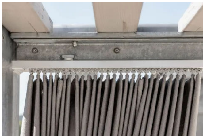
Profil HM-20150 für den Außenbereich | Kantonsschule in Olten, Kanton Solothurn (© LOSYS GmbH)
