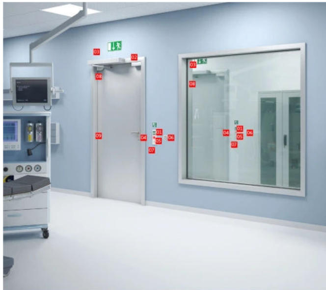
Fluchtwegsicherung SafeRoute: Schleusenbereich zwischen zwei OP-Saal-Türen
