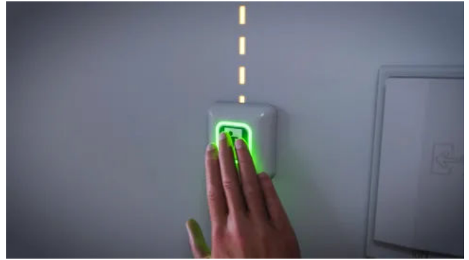
Durch Betätigung reagiert das System mit Steuerbefehlen für die Fluchttüren.
