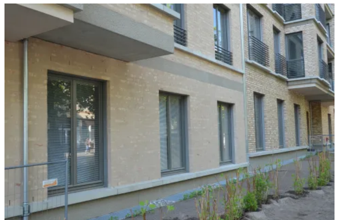
Der Schlämmputz auf Ziegel und das Sichtmauerwerk aus Ziegel wurden mit Fluorosil® Premium unsichtbar geschützt, Berlin, Prenzlauer Berg
