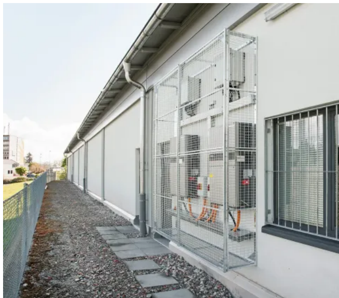
Vandalenschutz mit wandmontierter Gitterbox
