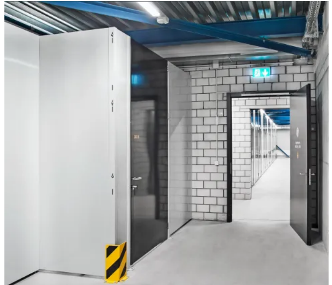
Unterteilung von Lagerräumen aus MultiGuard Stahlblechtrennwänden
