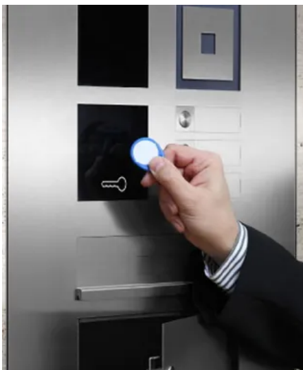
Zutrittskontrolle mit elektronischem Schlüssel
