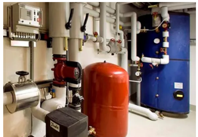
Trinkwassersystem mit Speicher
