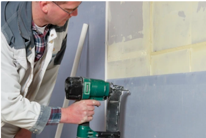
Keine Fugenhinterlegung mit Blei – statt dessen kommt nur Knauf Safeboardspachtel zum Einsatz.
