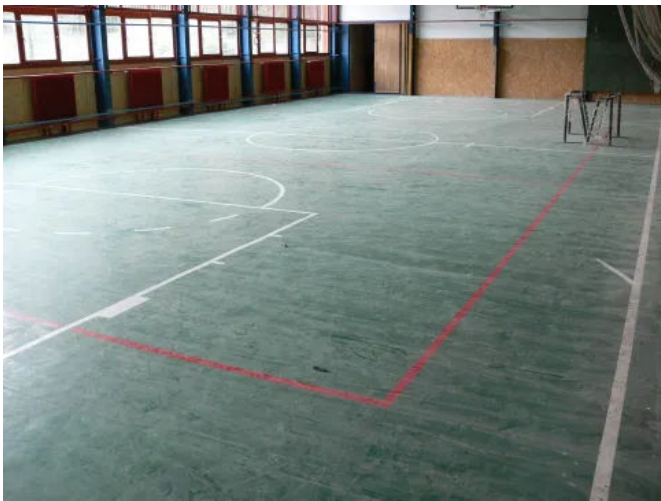
Sporthalle vorher: abgenutzter Boden
