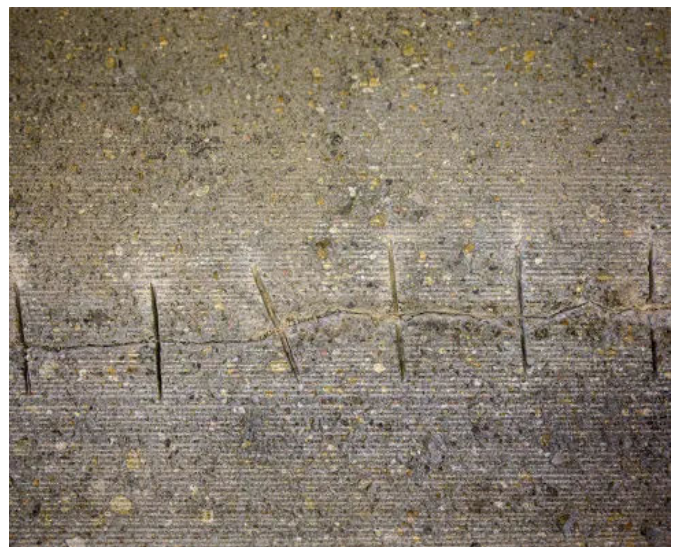
Rissverharzung (© Christoph Mertens)
