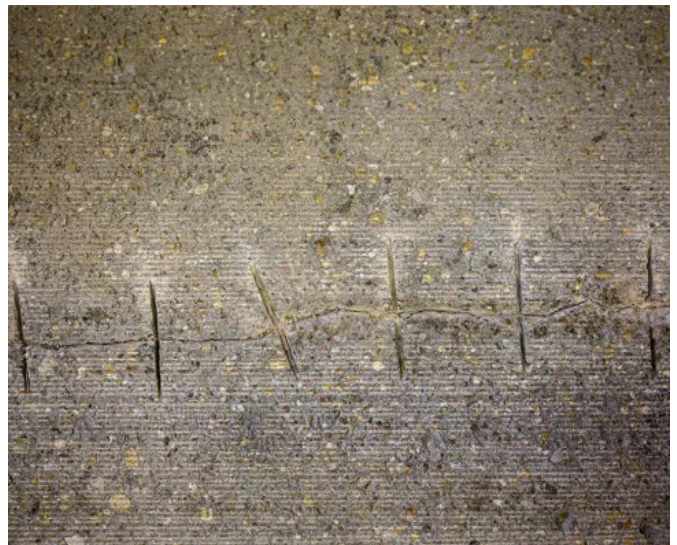
Rissverharzung (© Christoph Mertens)
