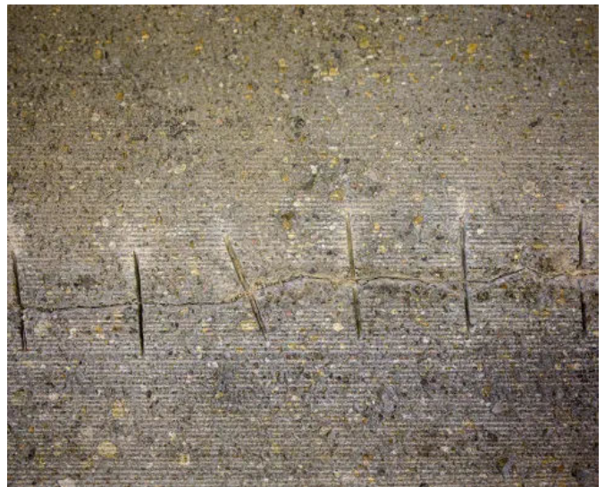
Rissverharzung (© Christoph Mertens)
