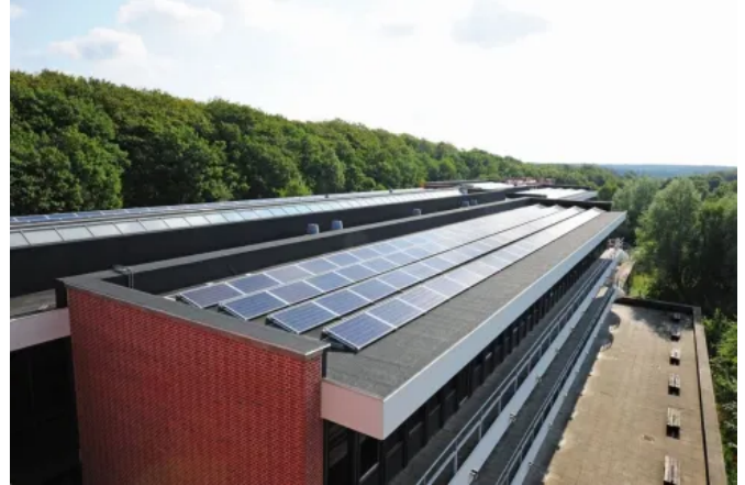
Die Unterkonstruktionen ermöglichen dank ihrer Süd-Ausrichtung von 15 Grad für besonders hohe Erträge während der Mittagsstunden.
