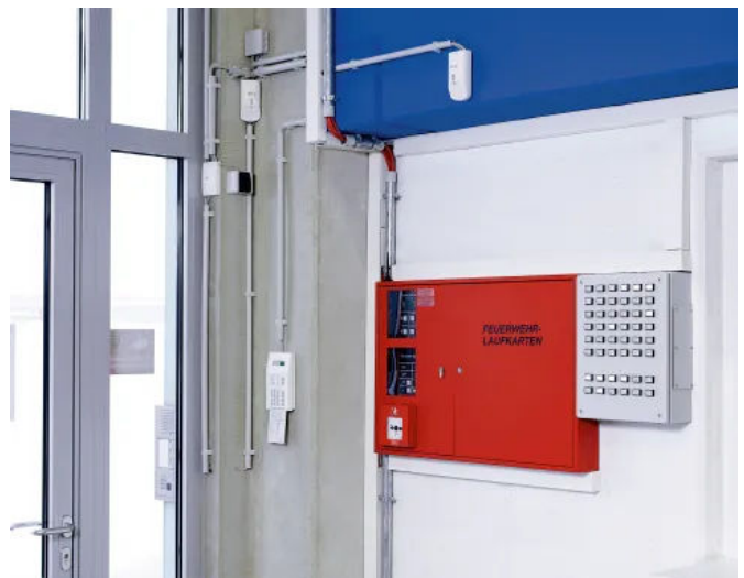
Sicherheit am Personaleingang ©TELENOT
