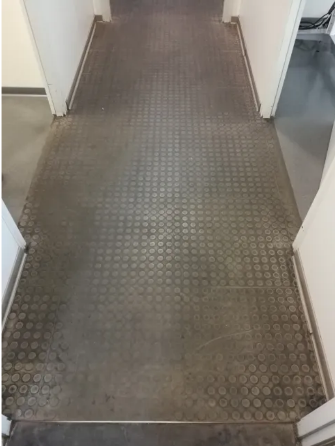
Vorher: Büroflur mit abgenutztem Boden
