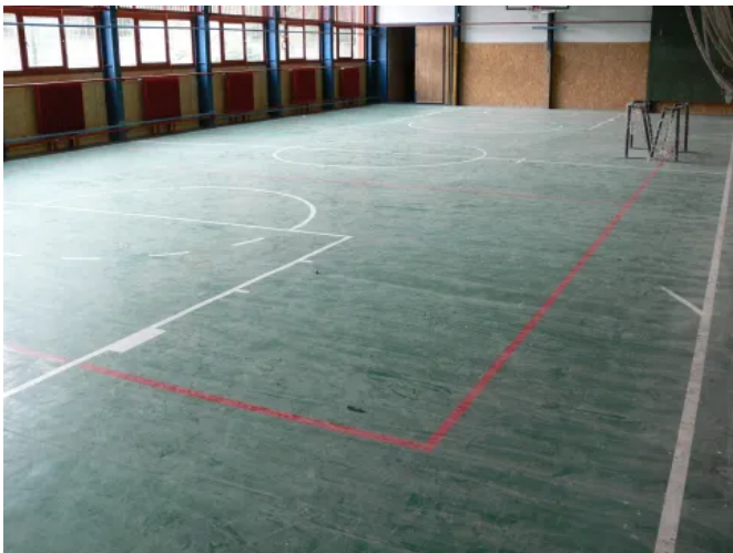
Sporthalle vorher: abgenutzter Boden
