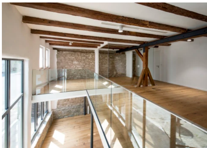
Für die Sanierung der Huchler-Scheune galt es, eine Lösung zu finden, ohne viel Eigengewicht einen Höhenausgleich von 35 cm zu schaffen. Besondere Herausforderung für die Statik. Die historische Stadtmauer ist zugleich tragende Außenwand und das gesamte Objekt lehnte daran auf.
