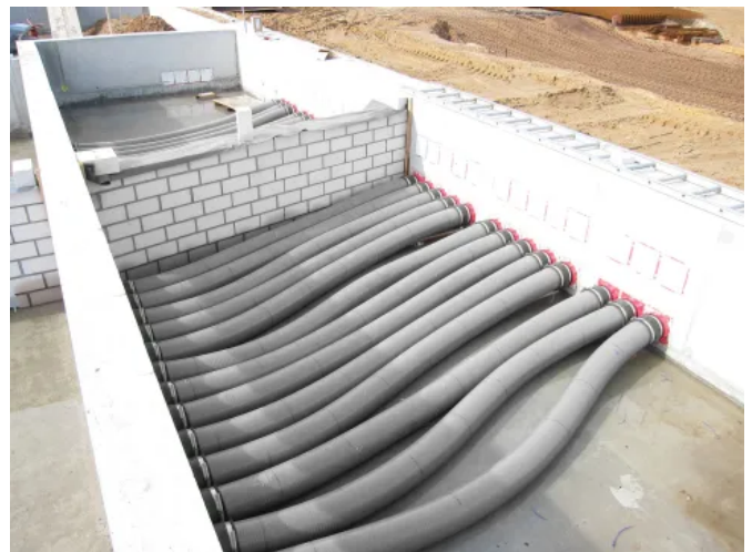
Kabeleinführungen mit Hateflex Spiralschläuchen
