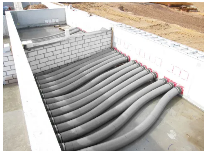
Kabeleinführungen mit Hateflex Spiralschläuchen
