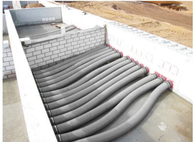
Kabeleinführungen mit Hateflex Spiralschläuchen
