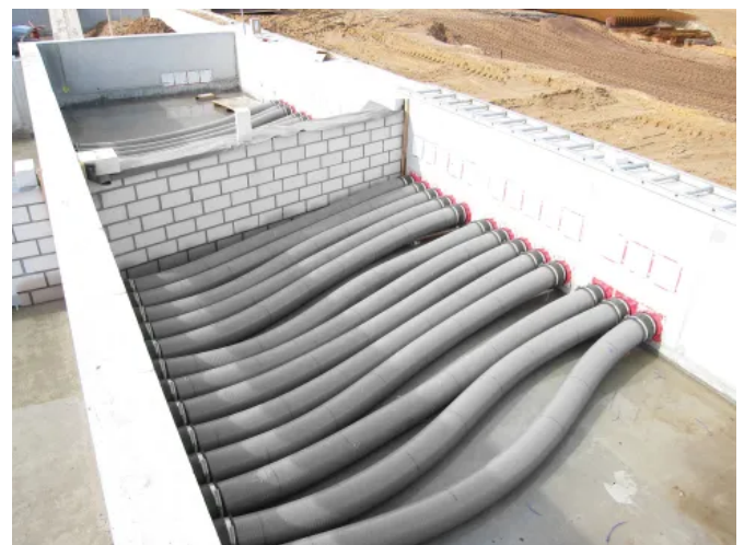
Kabeleinführungen mit Hateflex Spiralschläuchen
