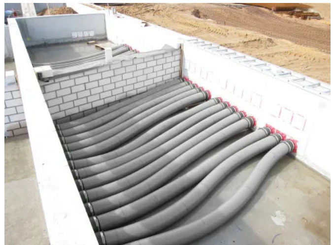
Kabeleinführungen mit Hateflex Spiralschläuchen
