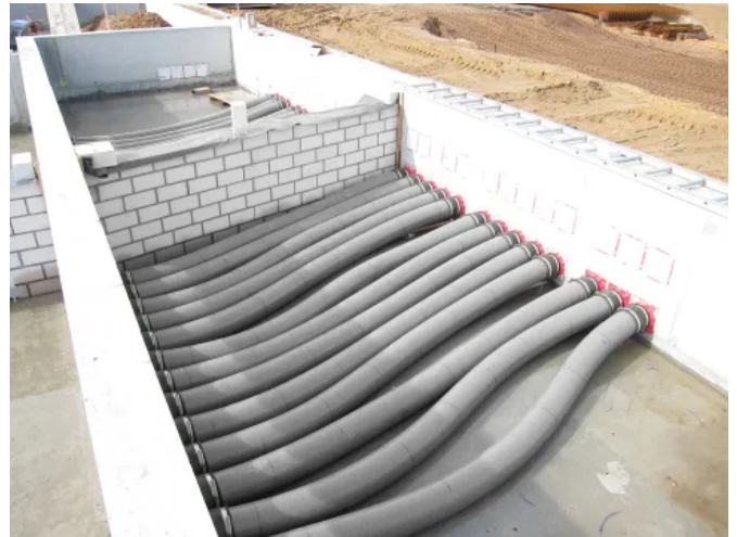
Kabeleinführungen mit Hateflex Spiralschläuchen
