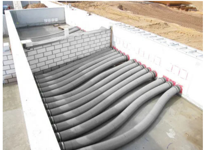
Kabeleinführungen mit Hateflex Spiralschläuchen
