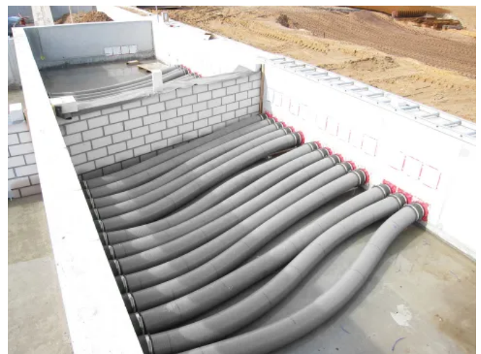
Kabeleinführungen mit Hateflex Spiralschläuchen
