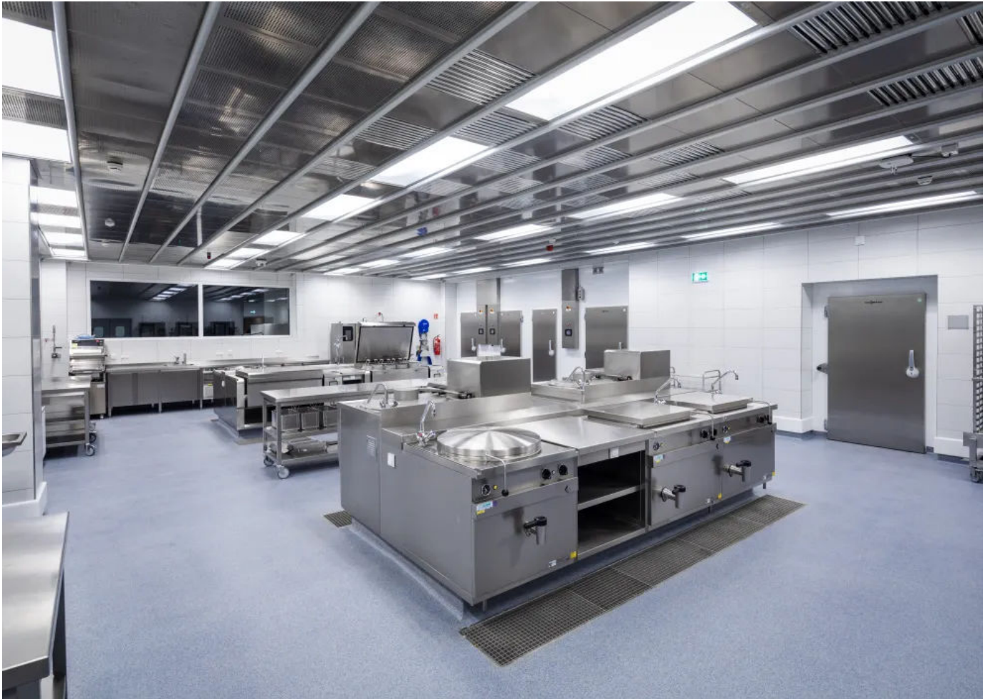
Bodenrinnen in einer Großküche (© Jan Meier, Bremen)
