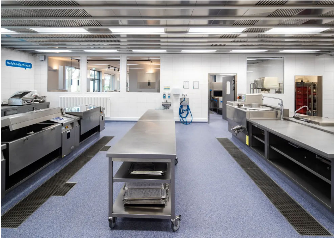
Bodenrinnen in einer Großküche (© Jan Meier, Bremen)
