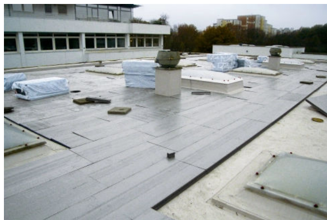
RAVATHERM™ XPS X 300 SL Platten werden im Verband verlegt, die Anschlüsse an Lichtkuppeln sind exakt anzuarbeiten
