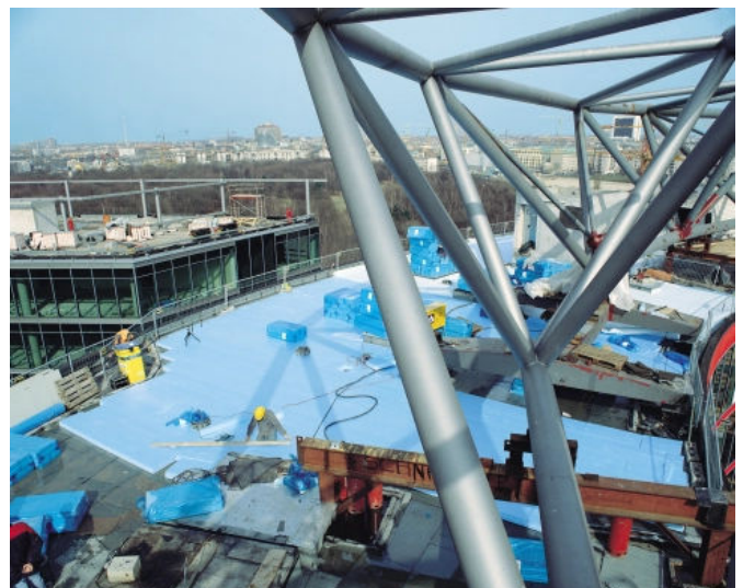
Die blauen RAVATHERM™ XPS Dämmplatten schützen die Dachabdichtung während der Bauphase (hier Sony Center, Berlin)
