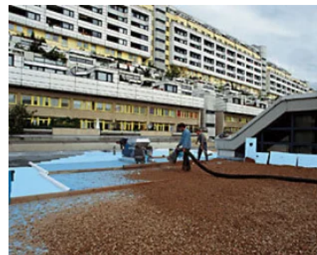
Als diffusionsoffene, wasserabweisende Trennlage folgt RAVATHERM™ XPS MK und anschließend die Kiesschicht
