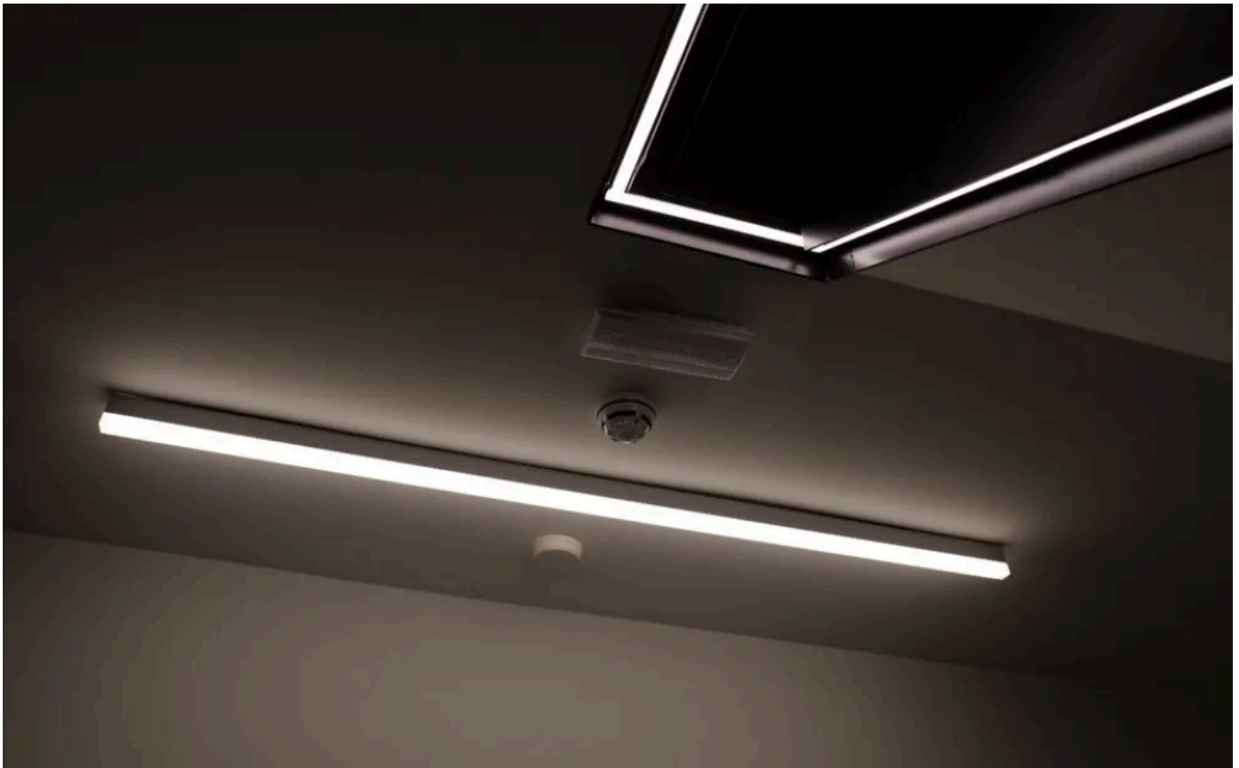
©B.E.G. Brück Electronic GmbH – Komfortabel, kosten- und energieeffizient ist die tageslicht- und anwesenheitsabhängige Beleuchtung von Fluren (Bild: B.E.G. Electronic GmbH_2)
