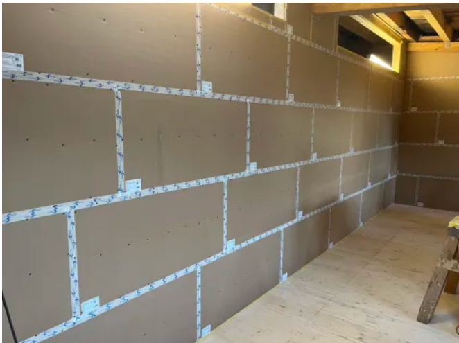
PhoneStar Platten als Schalldämmplatten an der Wand
