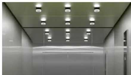
Die Beleuchtung in einer Aufzugskabine ist nicht nur notwendig, sondern auch ein vielseitiges Gestaltungselement.
