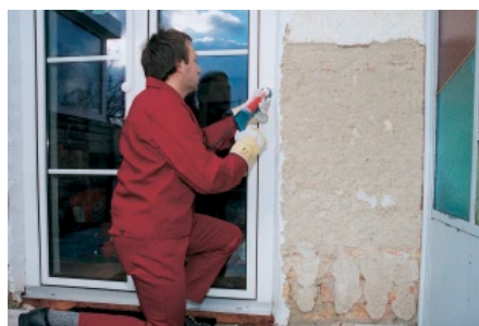
Putzrisse können mit PCI Adaptol plasto-elastisch geschlossen werden.
