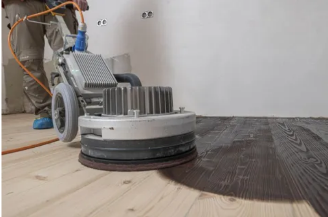
Die Ölgrundierung PALL-X 333 Color „Dark Brown“ wurde gleichmäßig auf der Fläche aufgetragen und nachpoliert.
