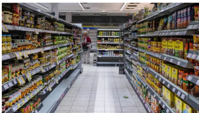
Bodenbelag im Konservengang vor der Sanierung
