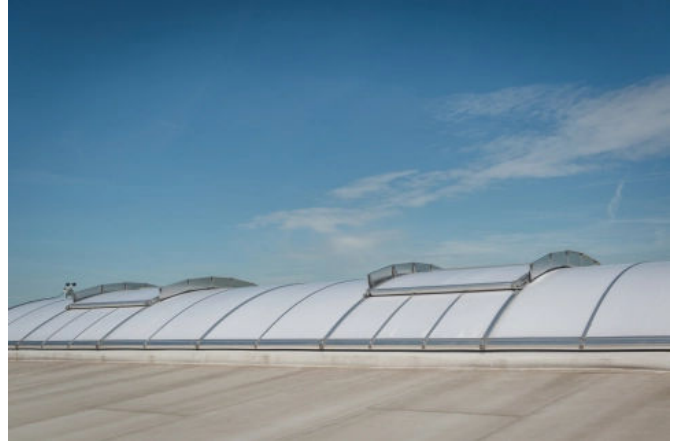
LAMILUX Lichtband B Passivhaus LINNENBRINK Maschinenbau GmbH in Warburg
