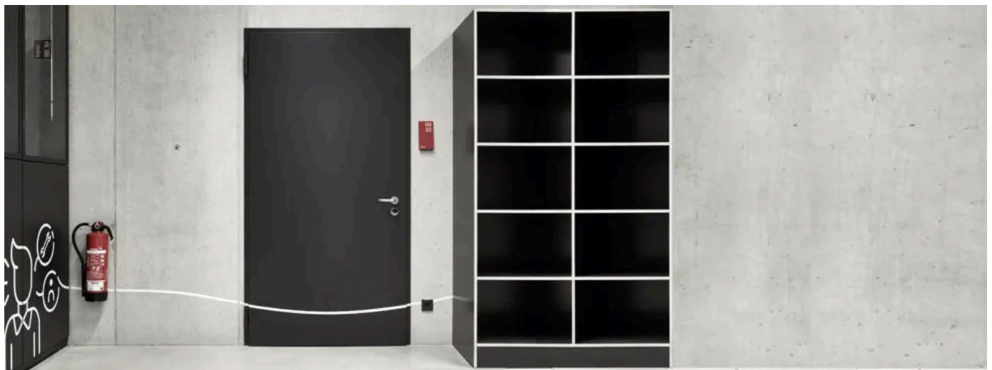
Brandschutztüren T30/El 2 30 | Gründer- und Innovationszentrum Munich Urban Colab
