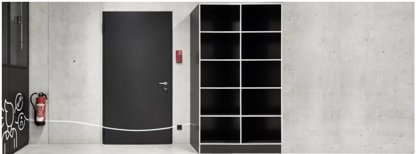
Brandschutztüren T30/EI 2 30 | Gründer- und Innovationszentrum Munich Urban Colab
