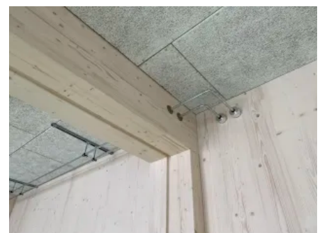
Querträger mit Akustikdecke und bewusst sichtbaren Rohrleitungen
