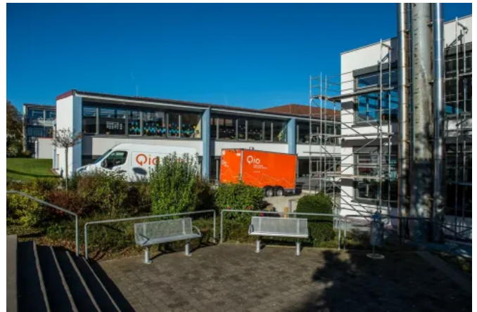
Einsatz der Qio Heizzentrale bei der Sanierung einer Schule
