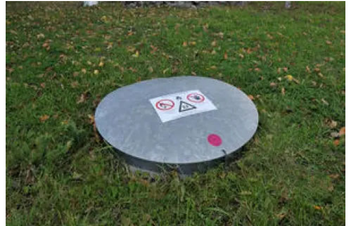
unterirdisch eingelagerten Behälter
