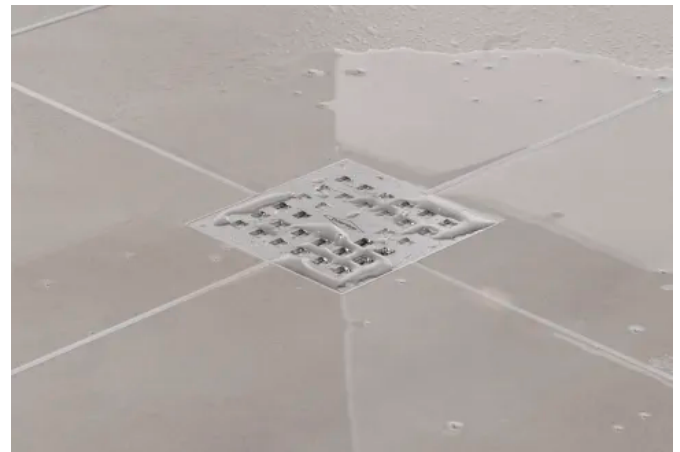
BLANKE DISK-CUBE verbaut
