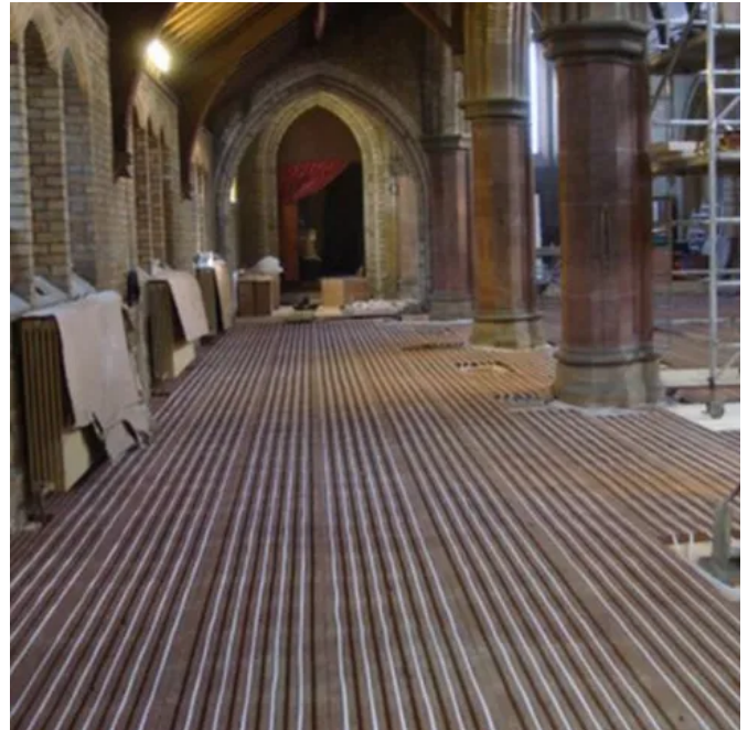
Effiziente Wärmeverteilung in denkmalgeschützten Gebäuden.
