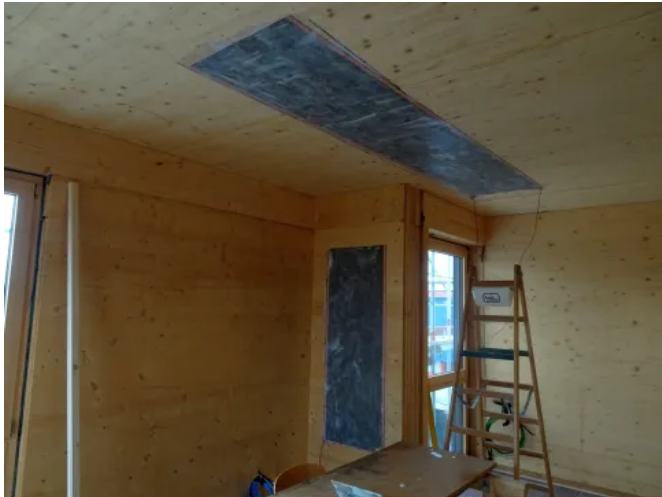
Infrarotheizung an Wand und Decke
