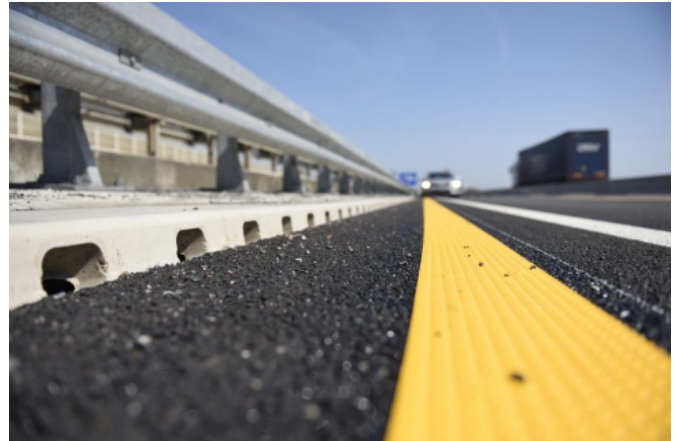
A1, Bad Schwartau – lineare Brückenentwässerung mit der ACO DRAIN® KerbDrain Bridge Ausführung OPA
