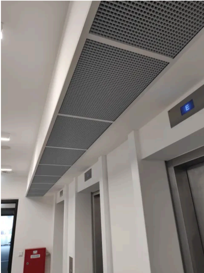
Anwendungsbeispiel Lichtrasterdecke im Eingangs- und Aufzugsbereich – dezente Integration von Beleuchtung und Technik.
