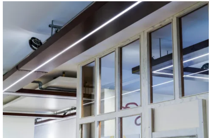
Ungelochte Kabelrinnen mit LED-Modul setzen Akzente.
