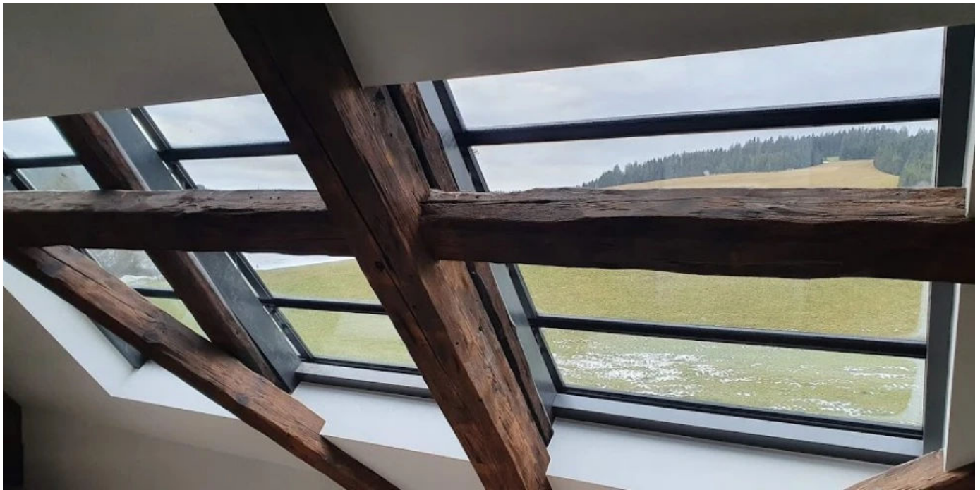
Objektbeispiel Lamellenfenster bigAir® Dach, Innenansicht
