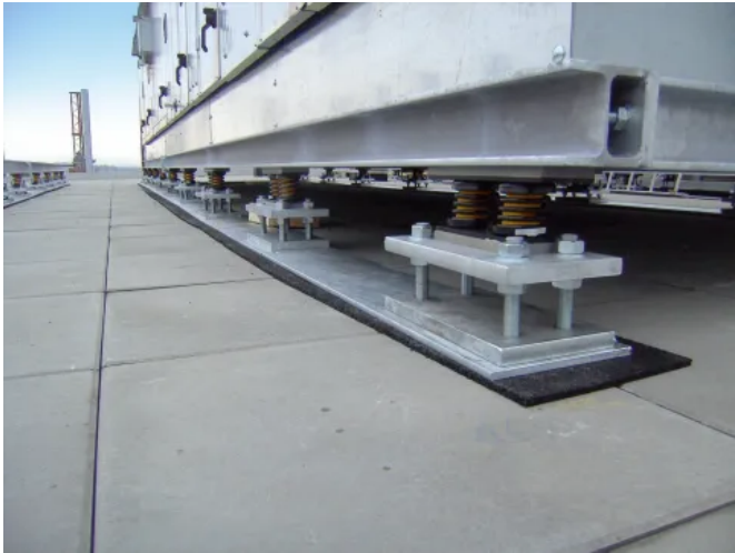
Lagerung eines Klimagerätes
