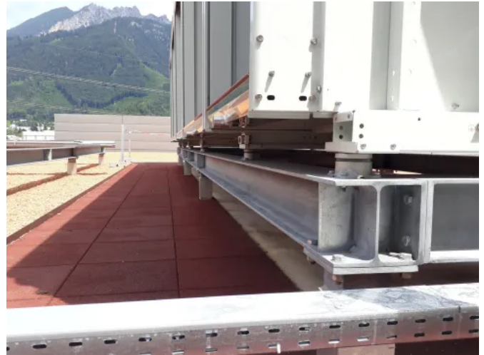
Lagerung der Kältemaschine mit Isotop auf dem Hauptgebäude der Fa. Getzner
