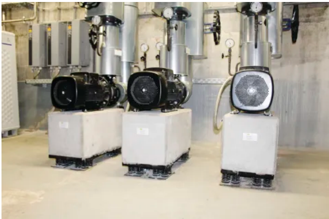
Lagerung von Pumpen auf Fundament mit Isotop SD Block
