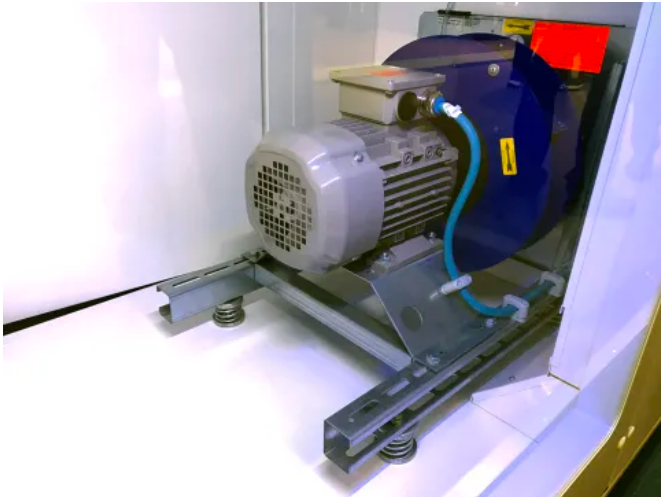
Lagerung eines Ventilators mit Isotop MSN
