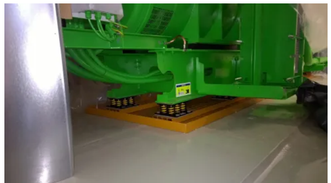
Entkopplung BHKW Jenbacher
