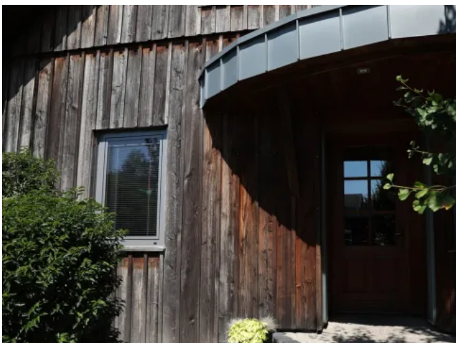
Das Erscheinungsbild der Holzfassade zeigt, dass sie ungeschützt und somit ungleichmäßig verwittert ist.
