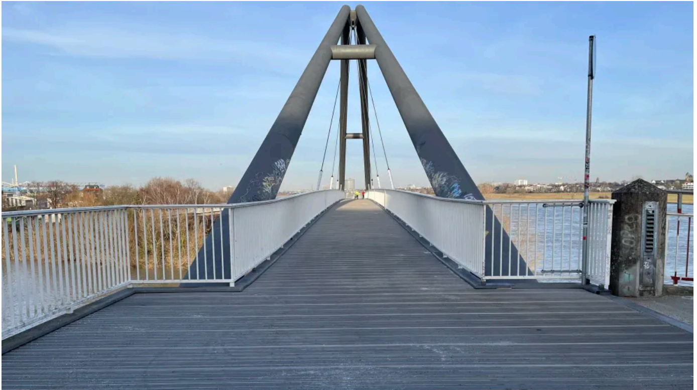
Sanierung der Brücke am Medienhafen in Düsseldorf mit TRIMAX® Kunststoffdielen mit geriffelter Oberfläche in grau
