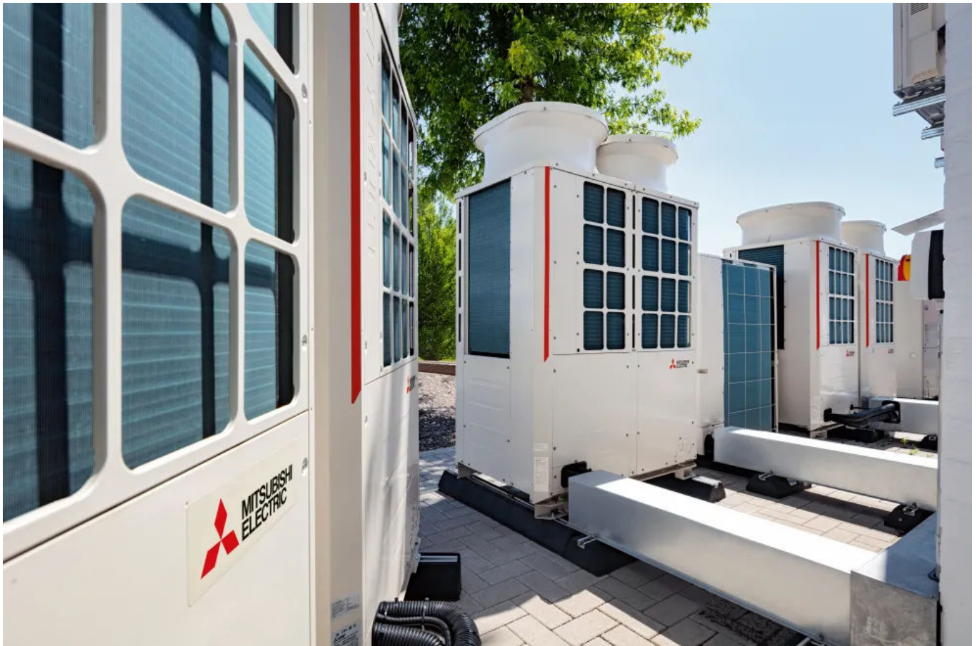
City Multi (H)VRF — Systeme, Anwendungsbeispiel Generator Hostel in Amsterdam
