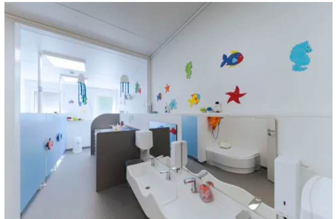
Bei temporären Kindergärten empfiehlt sich der Einbau von E-Heizern mit einer Oberflächentemperatur von max. 60 °C oder Invertergeräte. (© Rüdiger Mosler)
